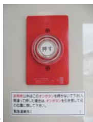
非常用押しボタン
