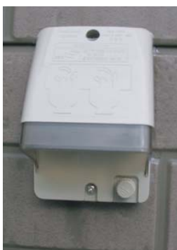
屋外コンセント
